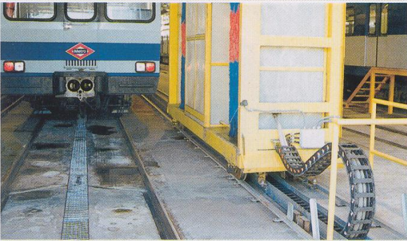
Impianto lavaggio automatico metropolitana Lunghezza percorso mt 120 - Catena portacavi LC 5500 Punto di attacco ribassato
